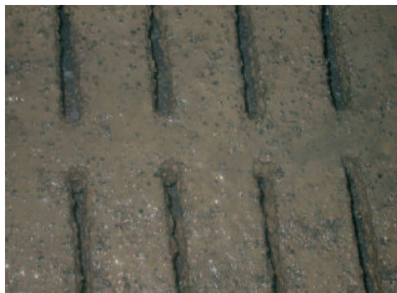
Fessurato in cemento usurato: si noti la difformità degli spazi e la fuoriuscita da calcestruzzo della ghiaia che provoca dolore ed eccessiva usura dell'unghia
