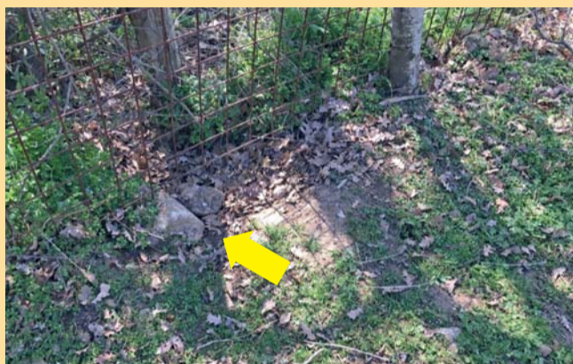
Animali "scavatori" possono modificare l'assetto della recinzione.
