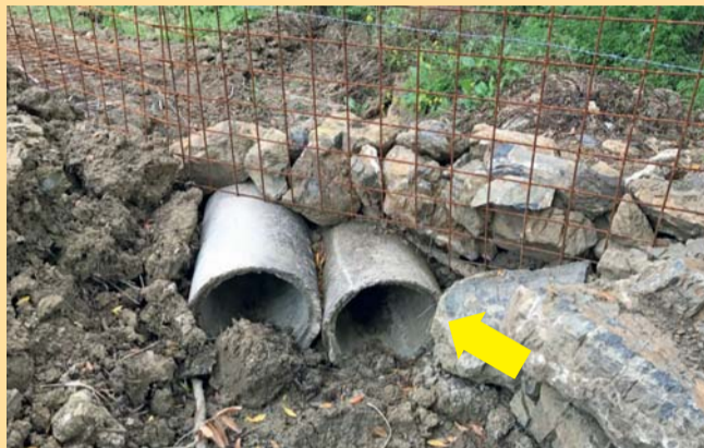
Lo scorrimento dell'acqua può modificare l'assetto della recinzione.
